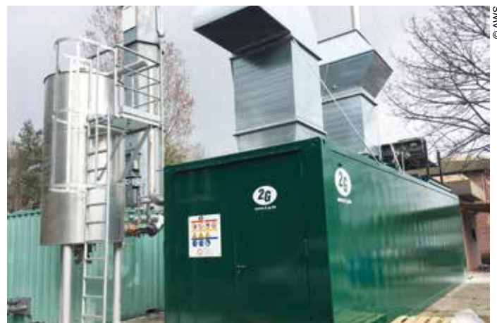
Deponiegasmotor von Außen
